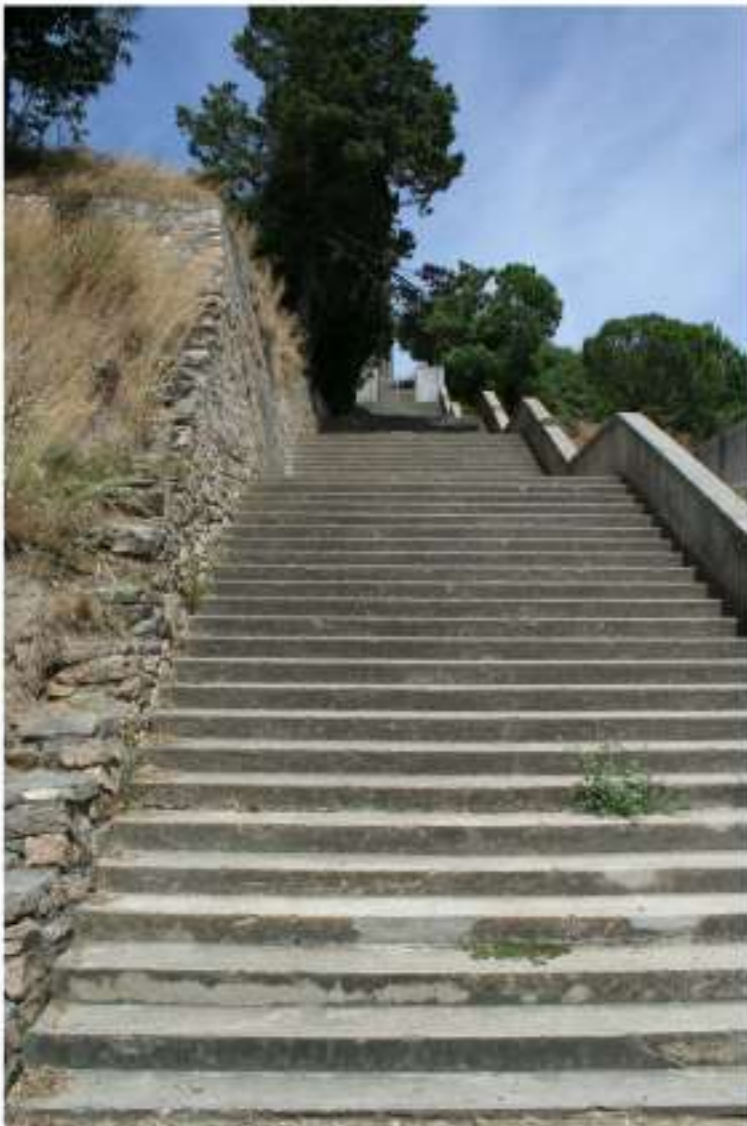
ESCADA EXTERIOR A RECUPERAR
